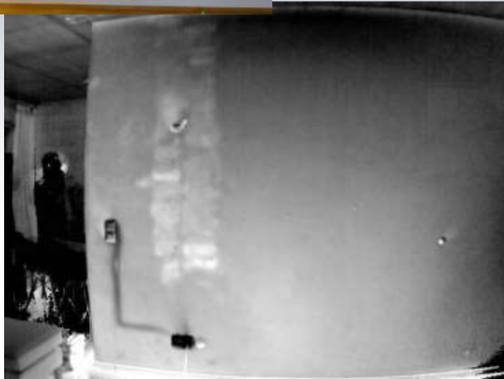
Nachweis eines abgeschnittenen und überputzten, versotteten Kamins.
