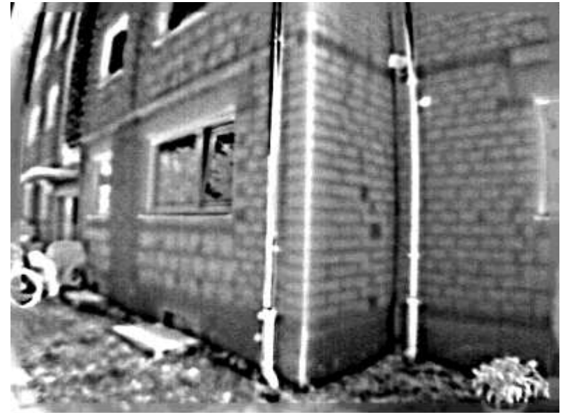
Verputzter, aber nicht gedämmter Altbau, Aufnahme gegen 14h gerade noch im Schatten.
