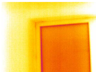
Bild 1: Thermografie Perfekt ausgeführter Fensteranschluss
