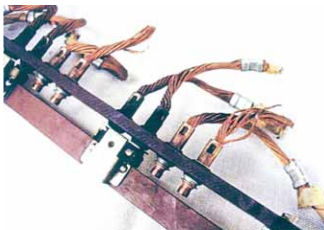
Der bereits massive Schmorspuren aufweisende Anpassungsschalter Bild: F. Mendel, A 3400 Klosterneuburg
