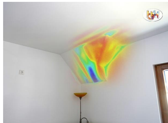
Bild 2: Defekt in Konstruktion der Gaupen
