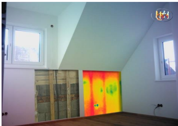
Bild 1: Luftdichtheit der Konstruktion außer Kraft
