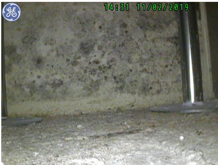
Bild 2: Schimmel auf der Betonoberfläche im Doppelboden
