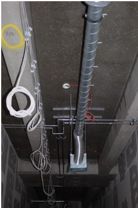
Bild 1: Kondensatbildung an der Unterseite der Betondecke
